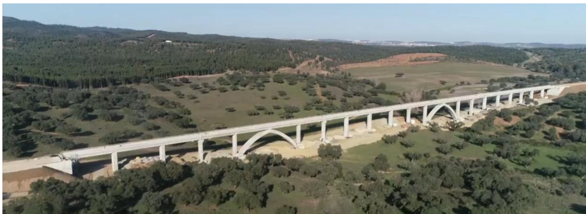
Fig. 8: Imagem aérea da Ponte do Barranco dos Pegões (fonte: Mota Engil Engenharia, SA)
